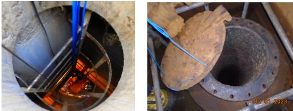
Figura 10. Bocal de visita de acesso ao flange na cobertura do túnel (primeira etapa do acesso) e flange de acesso ao túnel de descarga do SAC (segunda etapa do acesso).
