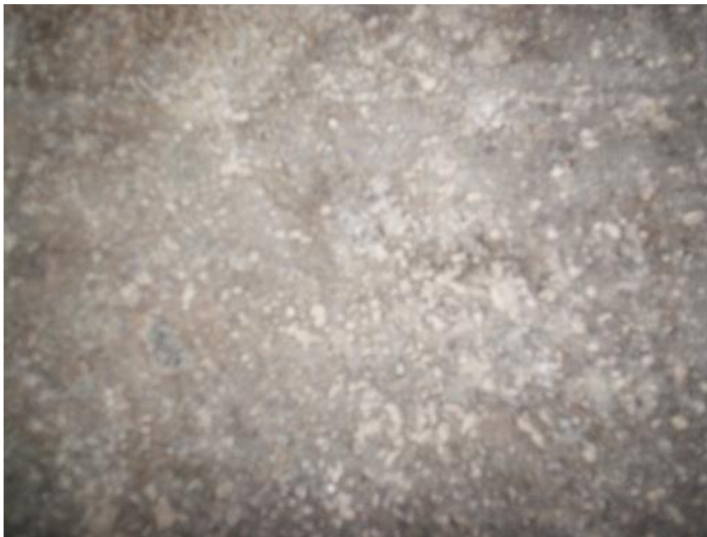
Figura 44. Registro fotográfico da patologia da estrutura de concreto armado da parede da galeria G2 e da patologia do esquema de pintura EP6Q5G2 aplicado no quadro Q5G2 na galeria G2.
