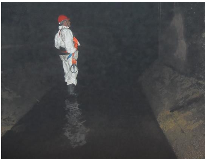
Figura 12. Inspeção de reconhecimento do ambiente da estrutura de descarga do SAC da usina Angra I.
