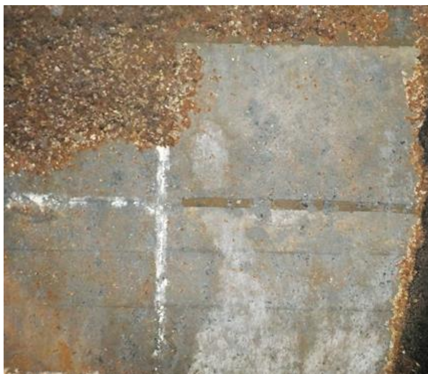
Figura 48. Registro fotográfico da patologia da estrutura de concreto armado da parede do Túnel T e da patologia do esquema de pintura EP6Q6T aplicado no quadro Q6T no Túnel T.
