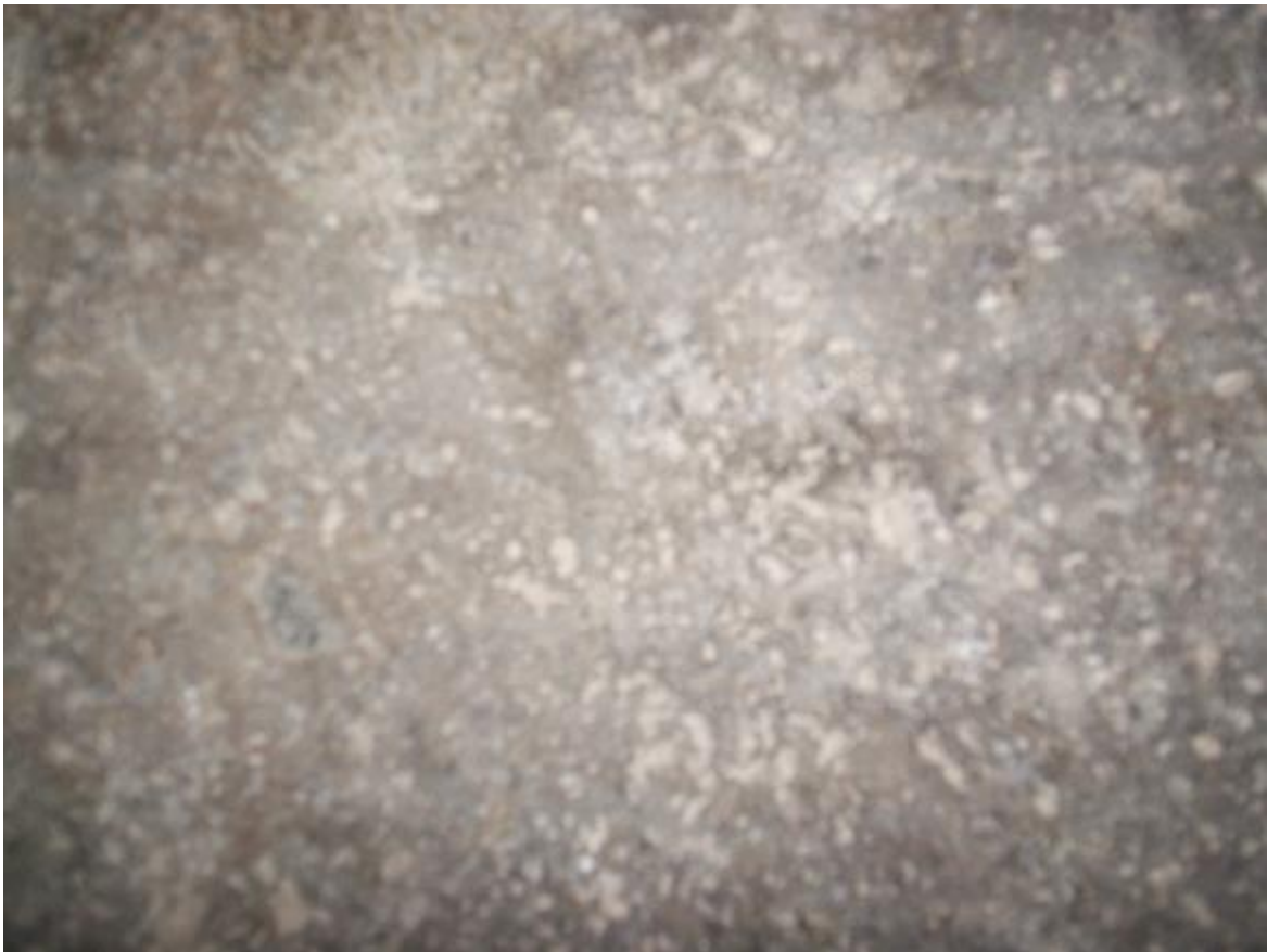
Figura 36. Registro fotográfico da Patologia da estrutura de concreto armado da parede da Galeria G2 e da patologia do Esquema de pintura EP4Q3G2 aplicado no quadro Q3G2 na galeria G2
