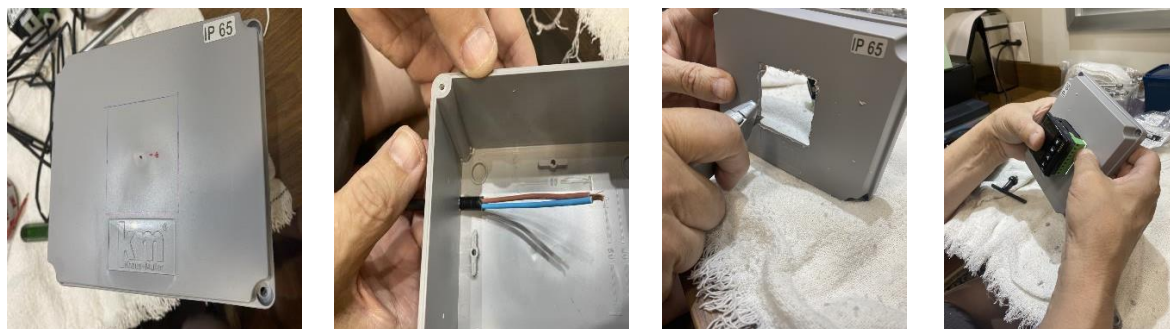
Figura 14: Preparação da caixa de passagem para permitir a passagem dos cabos e adaptação do sistema de controle de temperatura
