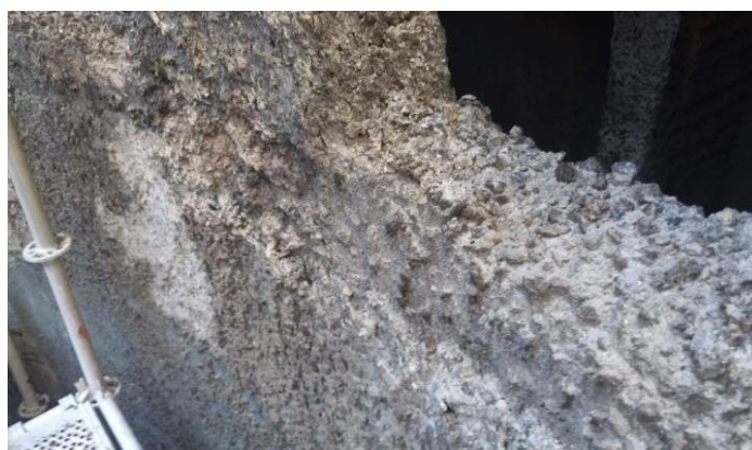
Figura 8 : Degradação do concreto devido a formação da taumasita
