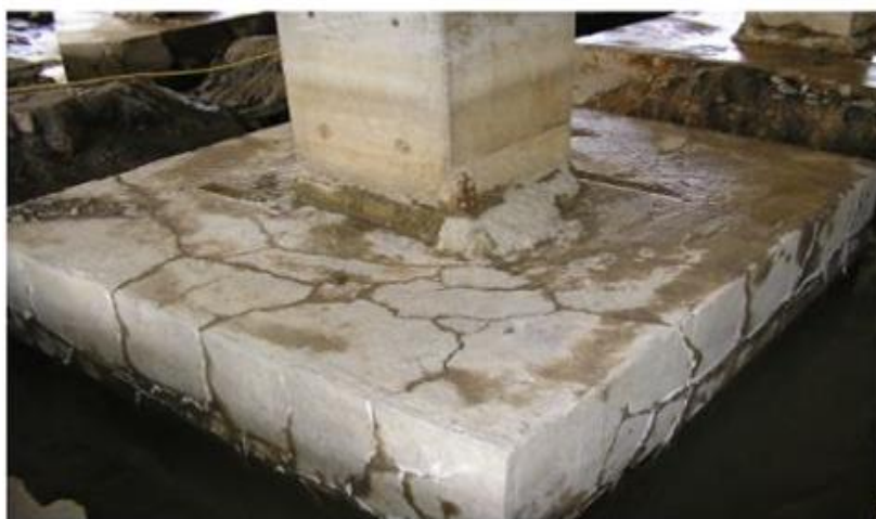
Figura 5 : Degradação devido ao processo da reação álcali agregado
