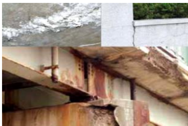
Figura 6 : Degradação do concreto devido ao ataque de íons sulfatos
