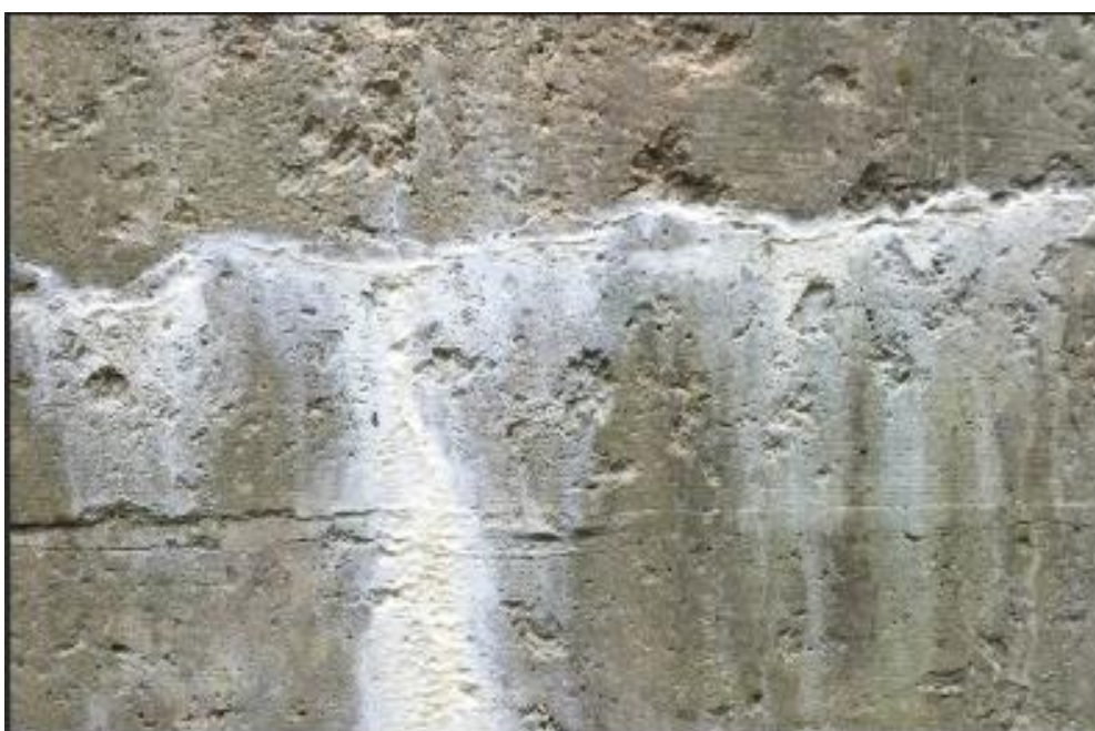
Figura 3: Degradação do concreto devido ao processo de lixiviação
