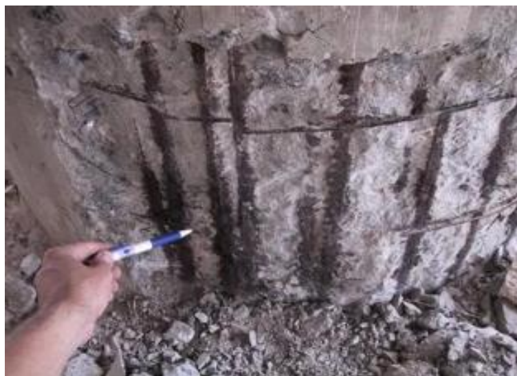
Figura 1: Degradação devido à carbonatação do concreto
