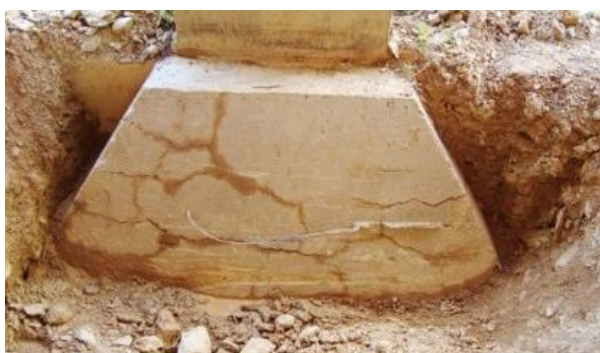
Figura 7 : Degradação devido a formação de etringita no interior do concreto
