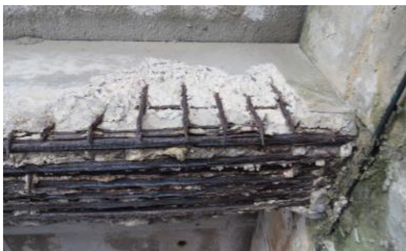
Figura 4: Degradação devido ao processo de corrosão das armaduras
