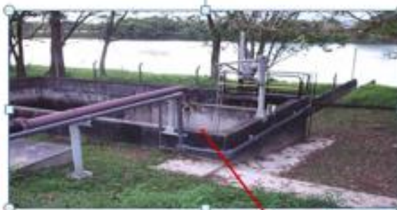
Bomba de emergência
