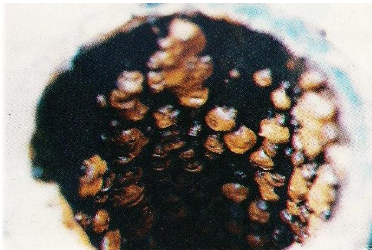
Figura 9 - Tubérculos em tubulação de aço-carbono, proveniente de corrosão microbiana. Fonte: Gentil (1996)
