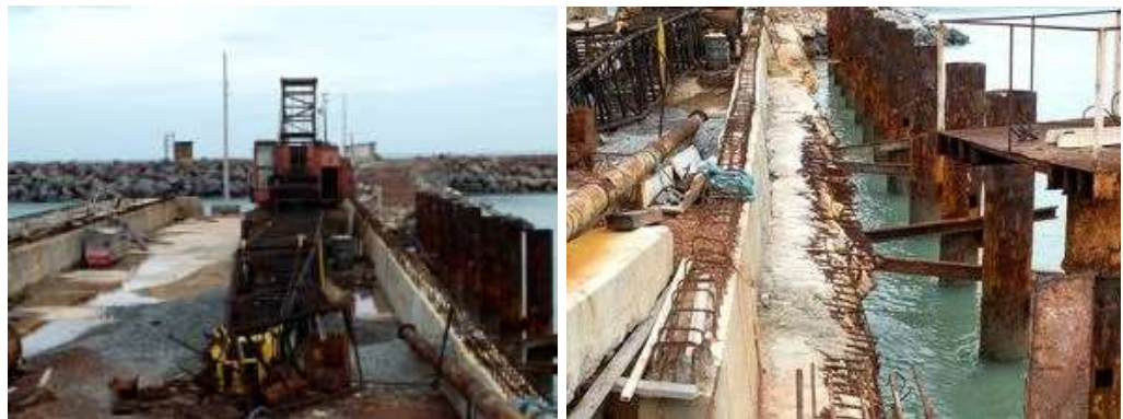
Figura 5 - Maresia já provocou a oxidação das estruturas de ferro utilizadas nas obras do porto
