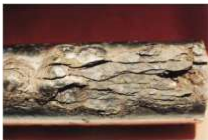
Figura 14 - Corrosão por esfoliação
