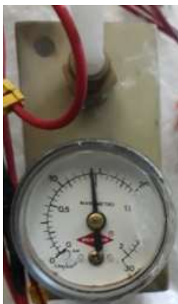
Figura 29. Manômetro do gabinete [Fonte: autor]
