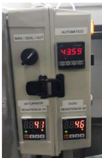
Figura 28. Painel elétrico de comando [Fonte: autor]
