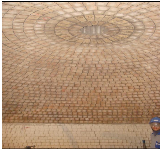
Figura 9 – Domo de um regenerador.
