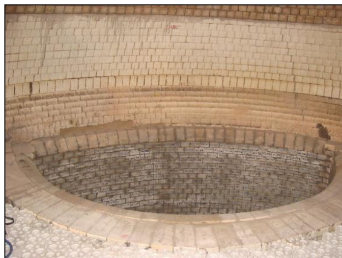
Figura 10 – Vista do topo da câmara de combustão.
