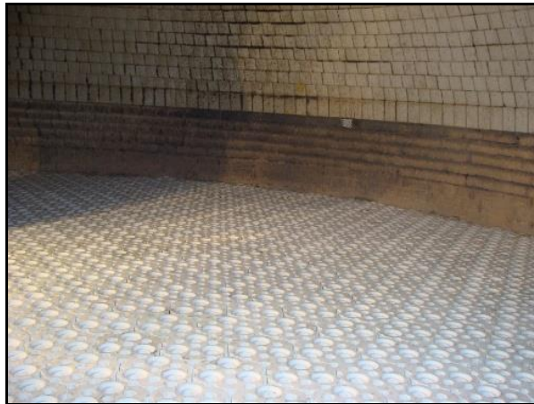
Figura 6 – Domo de um regenerador.
